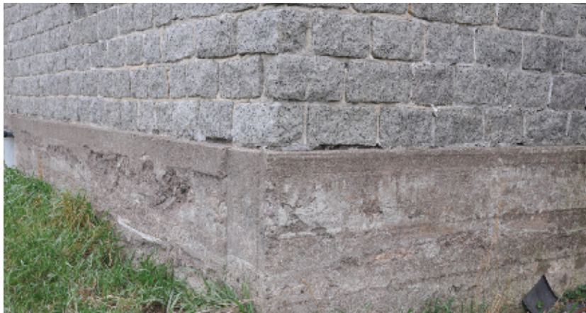
Fondation en béton, premier quart du XX e , dont le mur sud présente de l'écaillement. Noter la largeur des planches des coffrages, Brownsburg, Laurentides.
