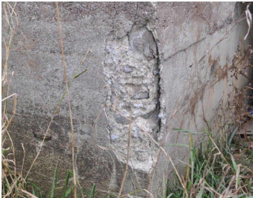
Écaillage d'un béton quasi centenaire relié au gel et dégel du béton sans air entrainé et à rapport eau/ciment élevé, Brownsburg, Laurentides.
