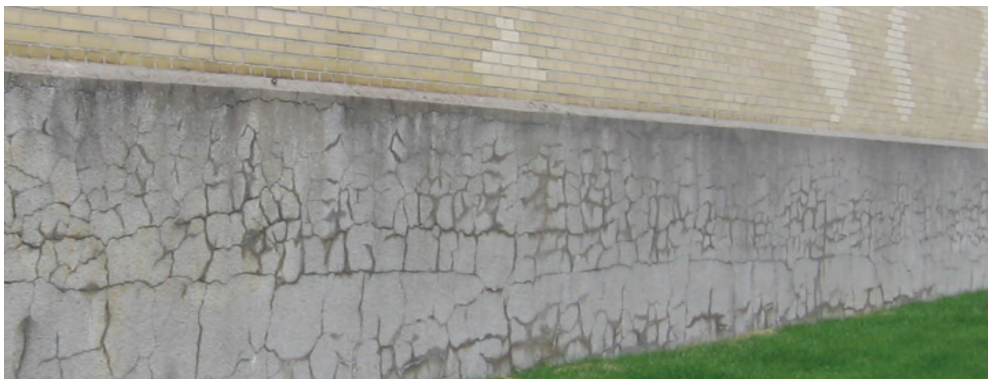
Béton affecté par une réaction alcali-granulats.
