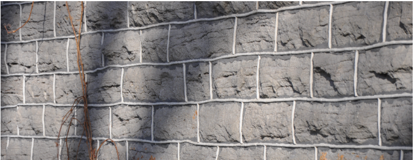
Photo 6 – Pierres de carrière grossièrement équarries, pierre grise de Montréal. Cap Saint-Martin, Laval.
