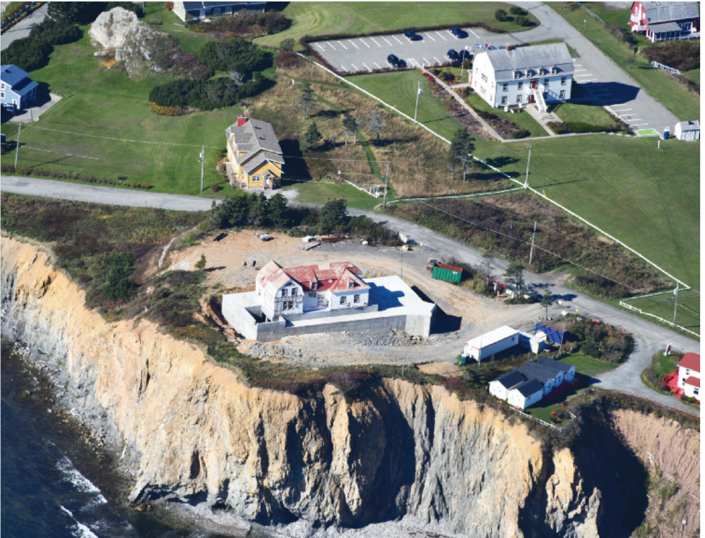
La maison Frédéric-James à Percé sur ses nouvelles fondations qui en auront permis la conservation.
